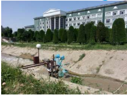
2-расм. ЖизПИИ ховлисидаги каналга ўрнатилган микроГЭС (куватти 0,5 кВт)
